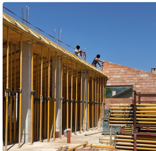
Foto 1. Riesgo de caída de altura durante la instalación de la línea de vida.
