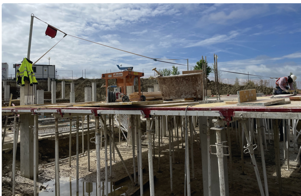
Foto 2. Dispositivo anticaídas retráctil con longitud excesiva
