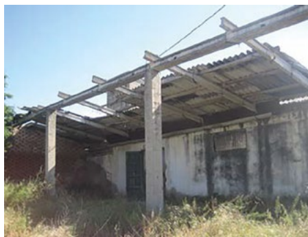
Cubierta de fibrocemento visiblemente deteriorada.
